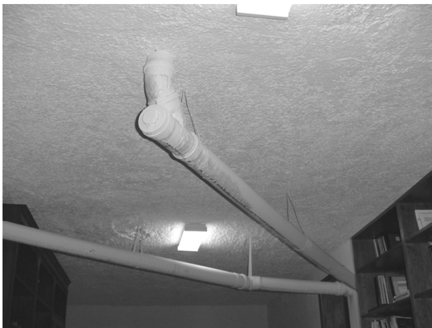
Figura 3 – Ligação de esgotos incorrecta e anti-regulamentar
