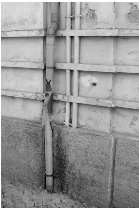
Figura 1 – Tubo de queda pluvial em PVC sem protecção
