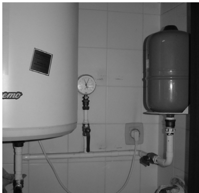
Figura 2 – Termoacumulador com vaso de expansão
